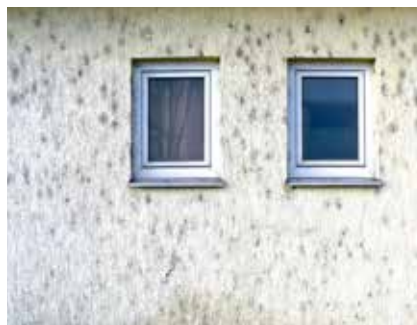
Von der Mauerspinne befallene und durch ihre Netze stark verschmutzte Hauswand.
